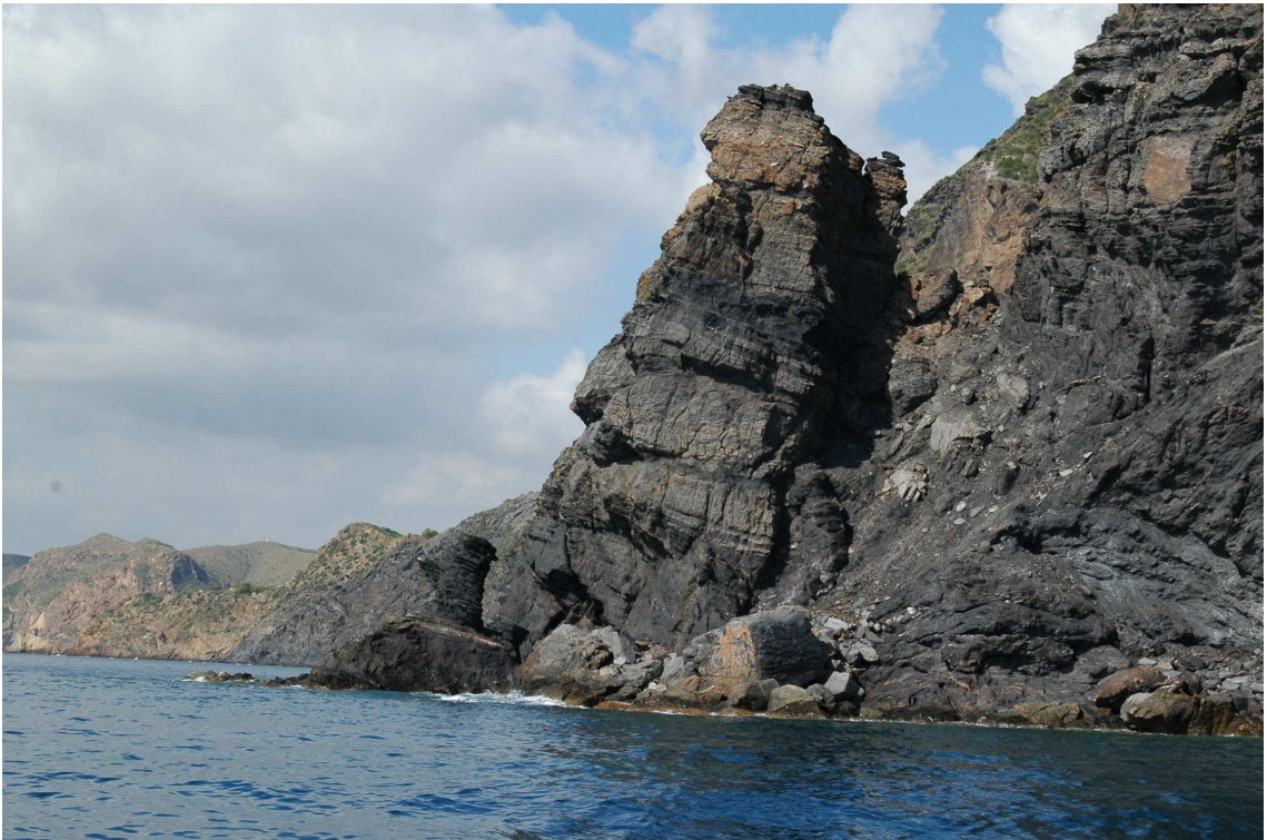
Detalle de los acantilados con desprendimientos.
